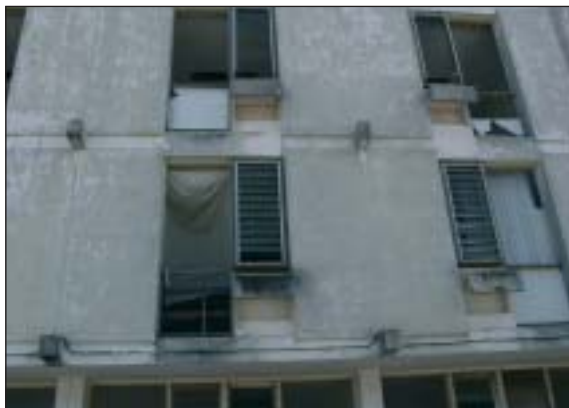
Figuur 2. De gevel van het Hospital de 24 Julho geeft een indruk van het verval van deze kliniek.
